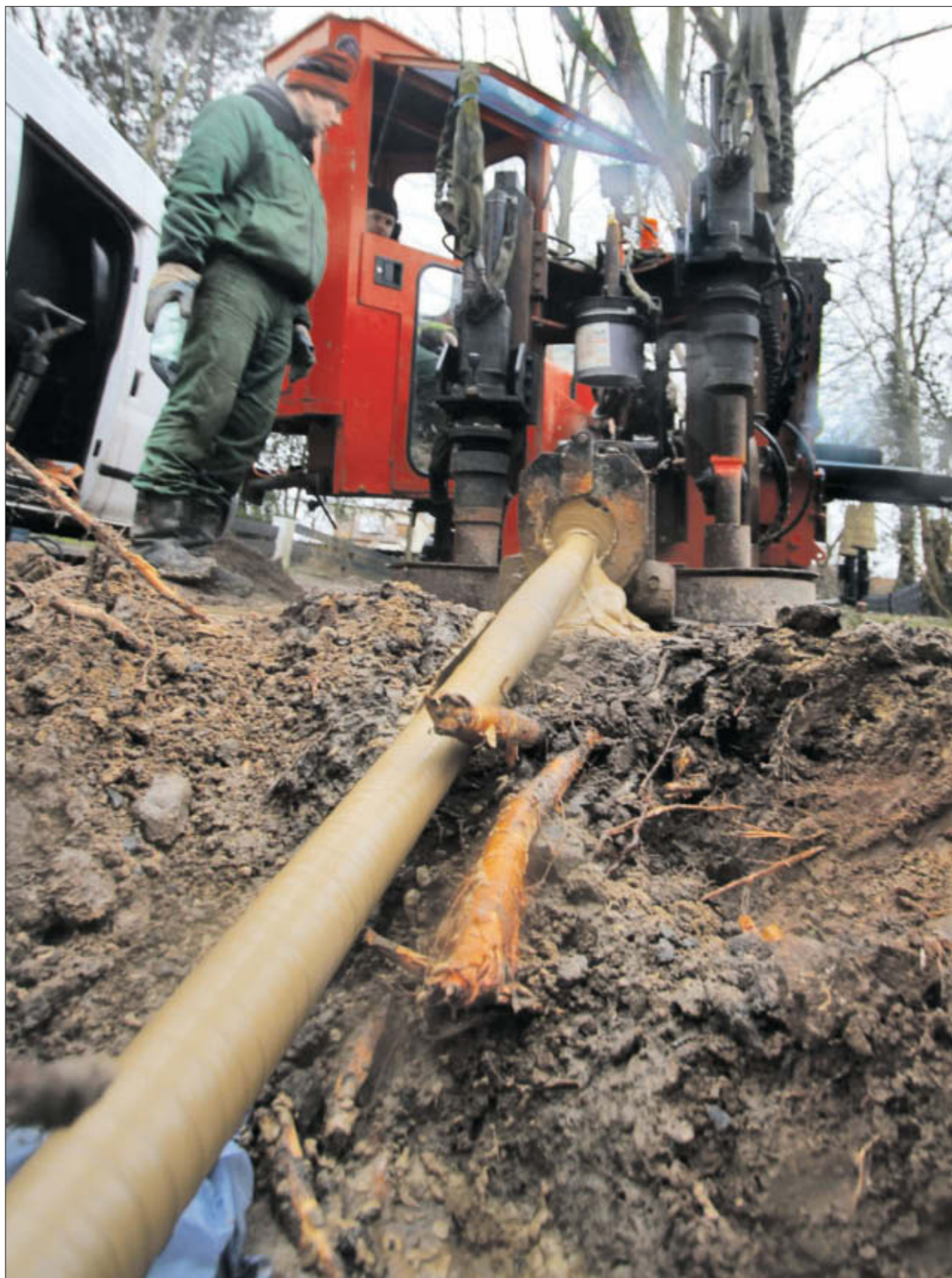
Mit einer gesteuerten Horizontalbohrung werden die neuen Wasserleitungen im Weg zum Hohen Ufer in Ahrenshoop einzogen. Foto: Timo Richter
